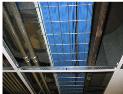
Industrial basket tray & conduit
